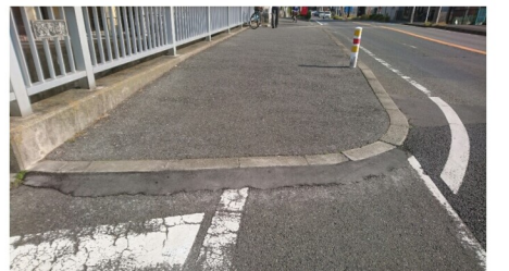
段差が解消されました
