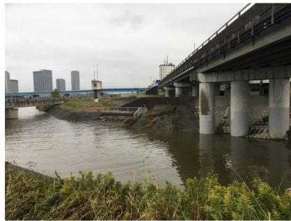
越水の爪痕が残っている 平瀬川合流部
